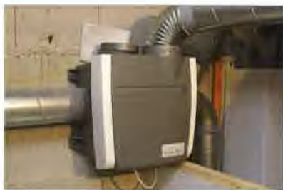
► Het mechanisch balansventilatiesysteem wordt gecombineerd met een Climarad radiator in de woonkamer.
