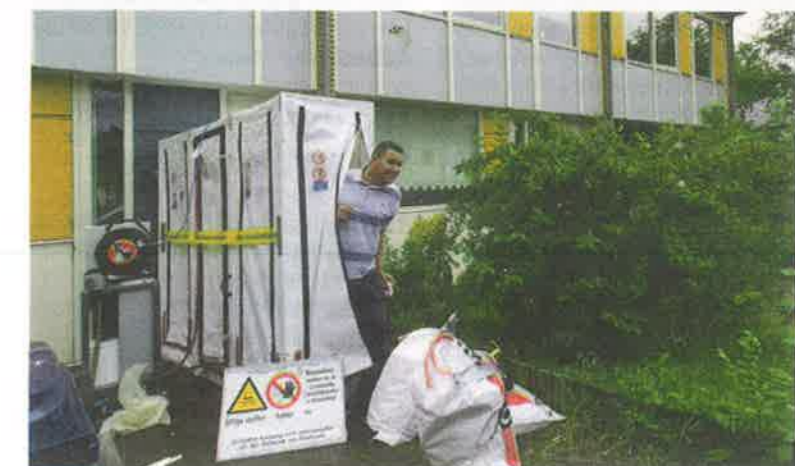
Onverwacht aangetroffen asbest gooide de planning op zijn kop.
